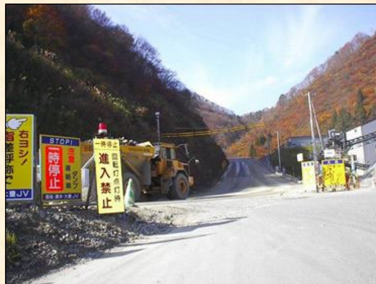
回転等を設置した交差点
